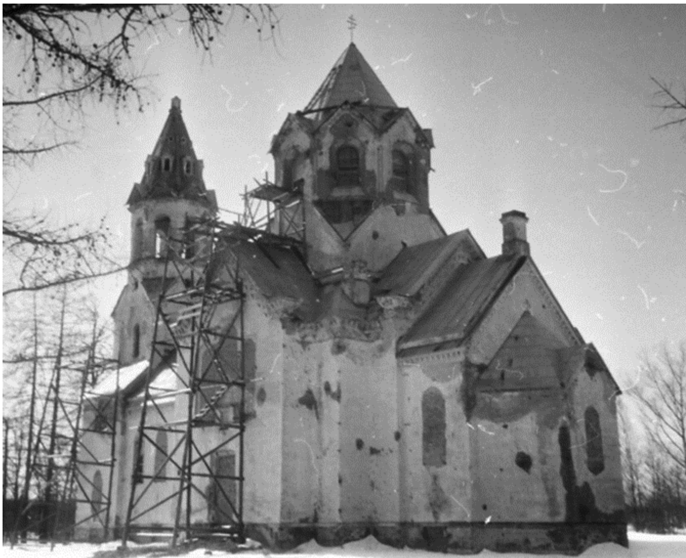
Церковь Происхождения честных древ Креста Господня. Храм перед реставрацией, фото 1996 года (на фасаде видны следы пуль и осколков)
