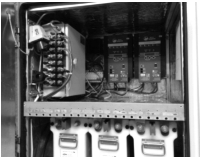
Рисунок 6. Расположение РИУ, контроллеров и АКБ в климатическом шкафу.
